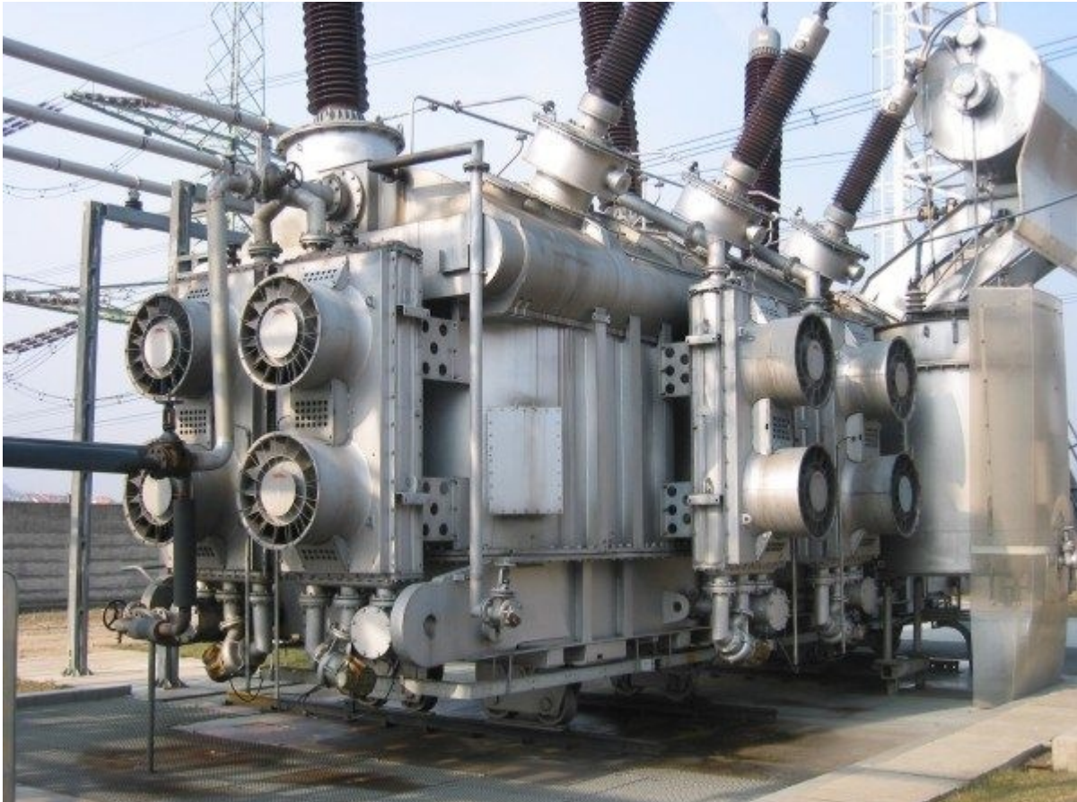
20. obr. Výkonový transformátor s oběhovými čerpadly a chladícími ventilátory
