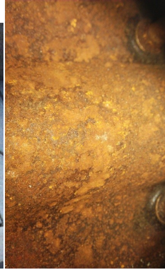
Obr. 71 – Koroze uvnitř nádrže
