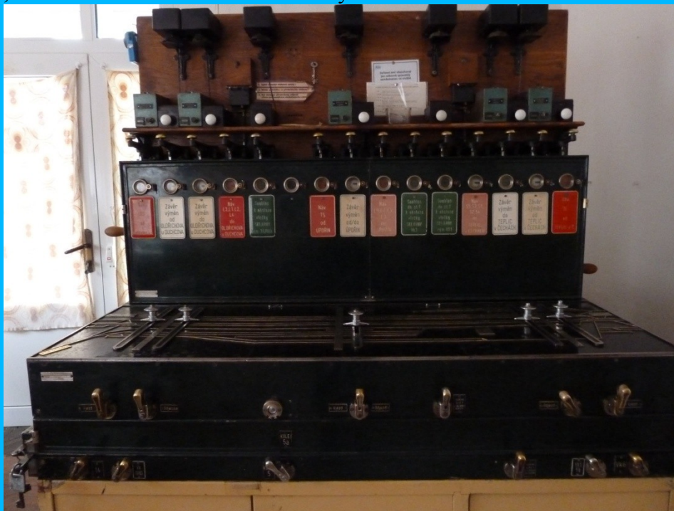
Obrázek č. 5 – ŽST Řetenice – elektromechanické SZZ Zdroj: autor
