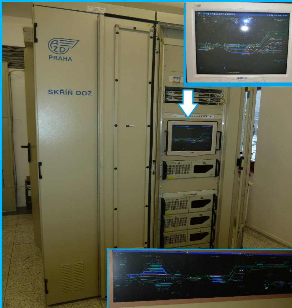
Obrázek č. 8 – ŽST Ústí nad Labem – ústřední stavědlo – skříň DOZ ESA 11 + audiovizuální deska Zdroj: autor
