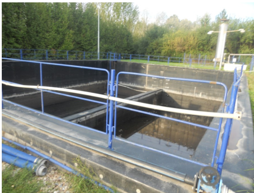
3.1 Jímka průsakových vod
